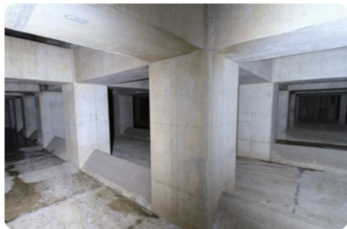
みなみすなうすいちょうせいち こうどうく 南砂雨水調整池(江東区)
